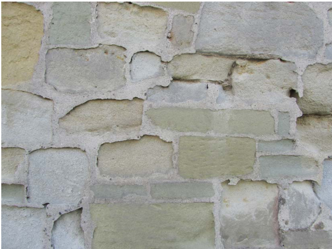
Mur de molasse ancien. Les remarques du tailleur de pierre sont donc exactes. Reste le dur des joints tandis que la pierre s'en va.
